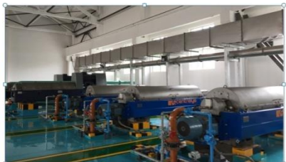
鸡冠石污水处理
