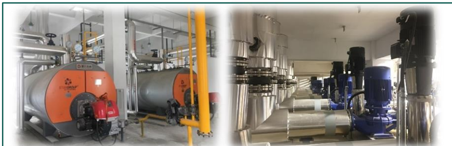
压滤及加热系统
